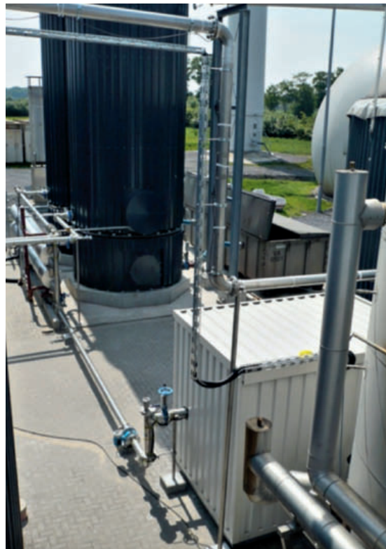
◀ Plant from outside Anlage von außen
