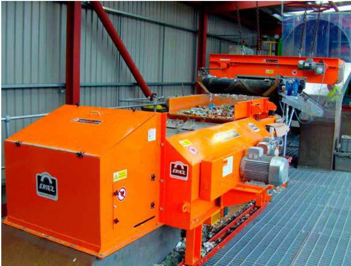
◀ ECS after overband ECS nach dem Überbandmagneten
